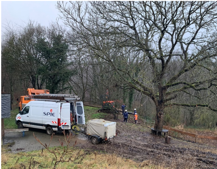
Mastbruch. Stromausfall auf der Waldeck
